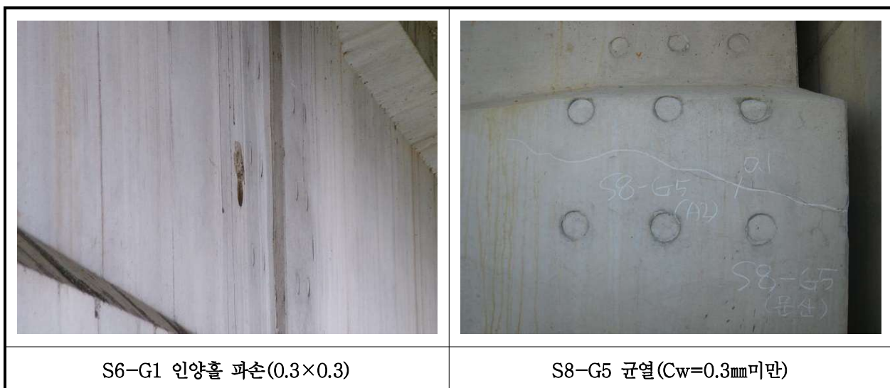
【사진 35.3.5】 거더 손상현황
