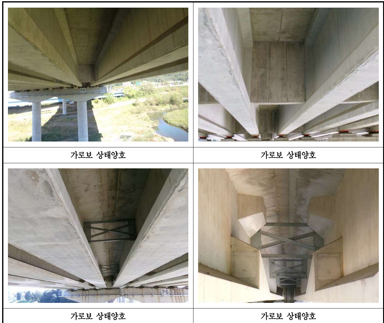
【사진 35.3.7】 가로보 손상현황
